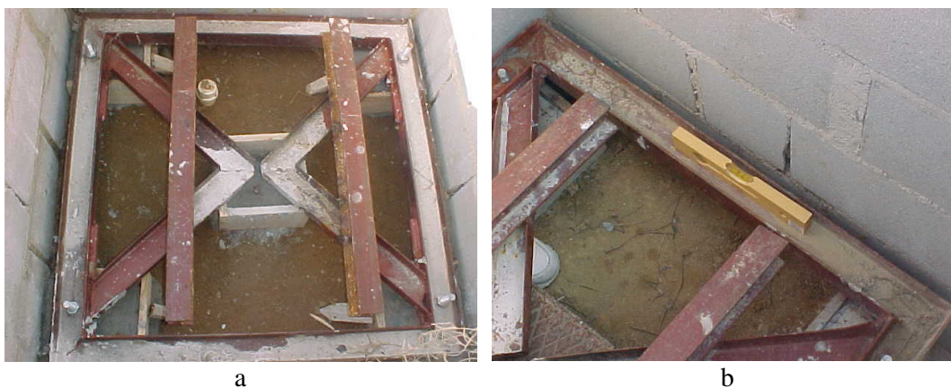
Figura 10 – Estrutura de apoio instalada no fundo do fosso (a), devidamente nivelada (b).
